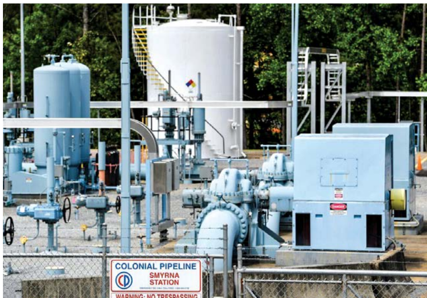
Một trạm Đường ống Colonial Pipeline được nhìn thấy ở Smyrna, Georgia, hôm 11/05/2021.
