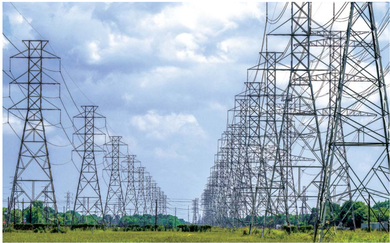
Hệ thống truyền tải điện tại một nhà máy điện ở Houston, hôm 09/06/2022.
