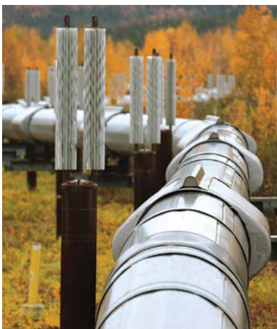
Một phần của Hệ thống đường ống xuyên Alaska ở Fairbanks, Alaska, vào ngày 17/09/2019.
