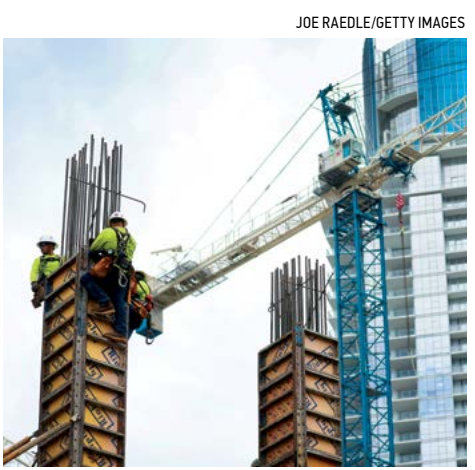
▲ Công nhân xây dựng xây dựng một khu dân cư cao tầng ở Miami vào ngày 02/10/2023.
