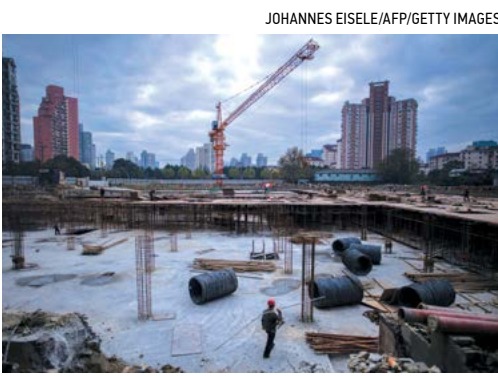
▲ Một người dân ông làm việc tại công trường xây dựng một tòa nhà cao ốc ở Thượng Hải, Trung Quốc trong bức hình tư liệu.
